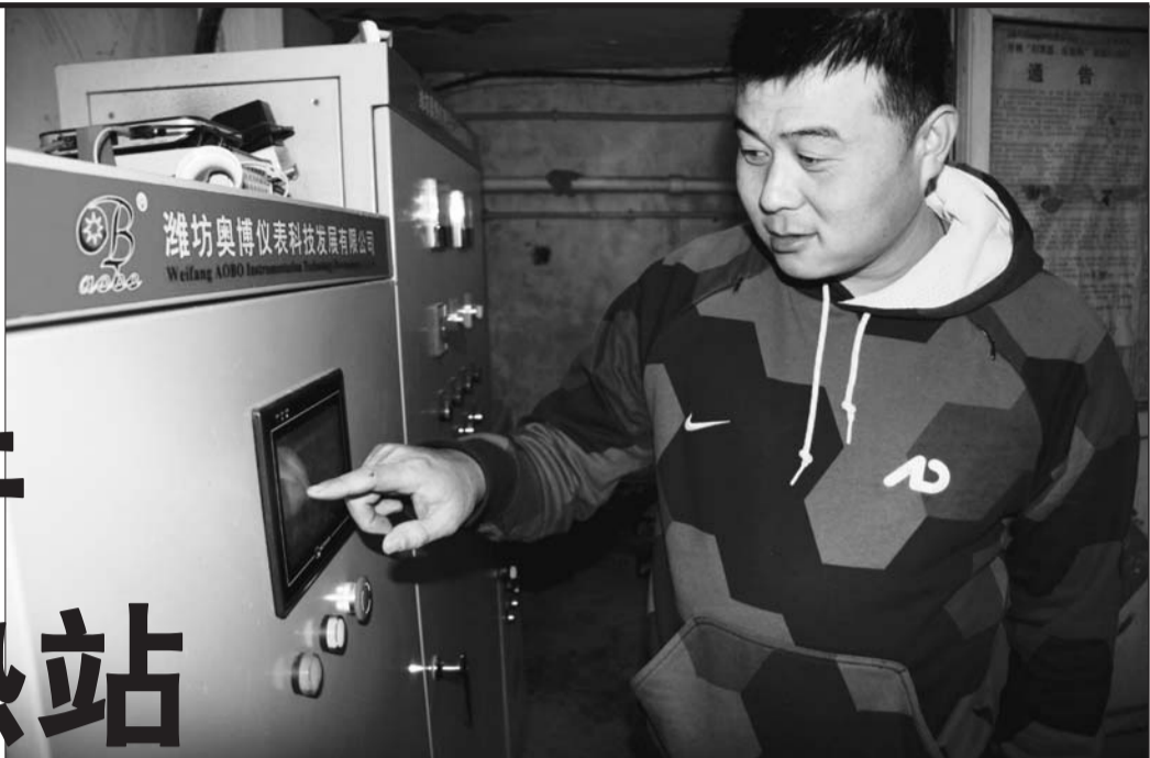
8日,在奎文区虞鑫花园小区内,潍坊热力公司的换热站站长胡伟正在调试设备。本报记者 吴凡 摄
