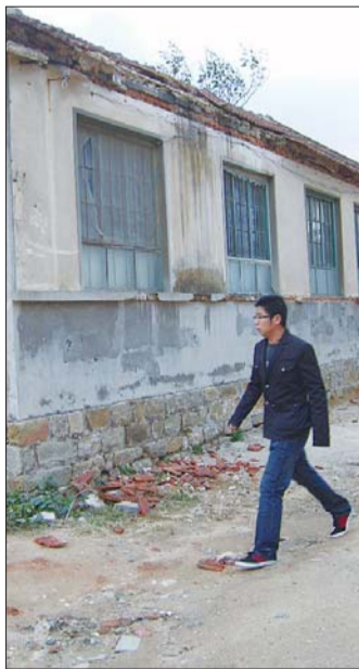
11日下午3点多,海滨小区一栋房屋屋顶的砖瓦被阵风吹落。记者 王晏坤 摄
