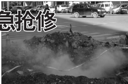
管道破裂处不断冒着热气。
