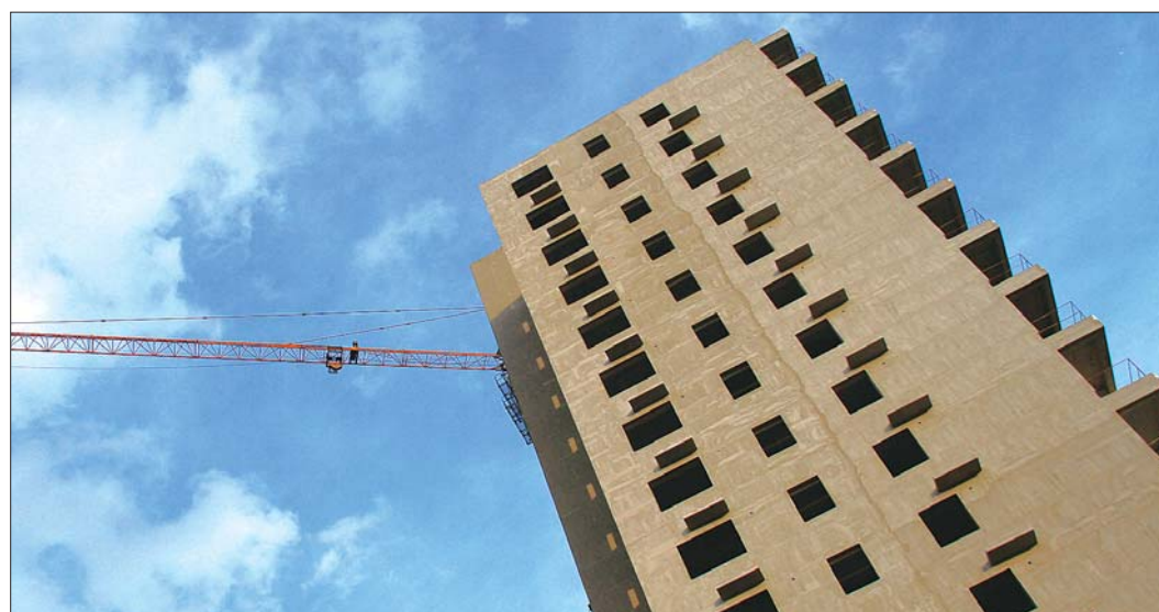
11月2日,聊城路公租房施工现场,一期工程正在进行内部装修。 本报记者 刘涛 摄
