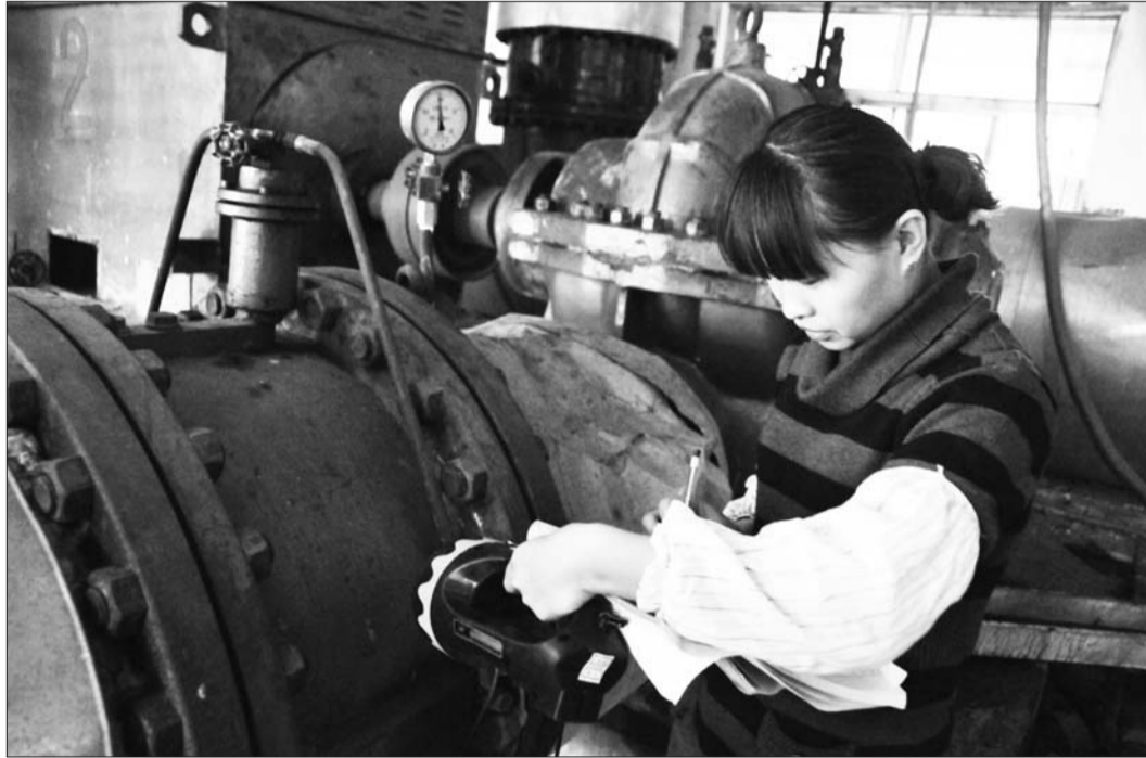
14日,鑫谊热力公司技术人员在操作间内记录水温和水压等数据。本报记者 李运恒 摄
