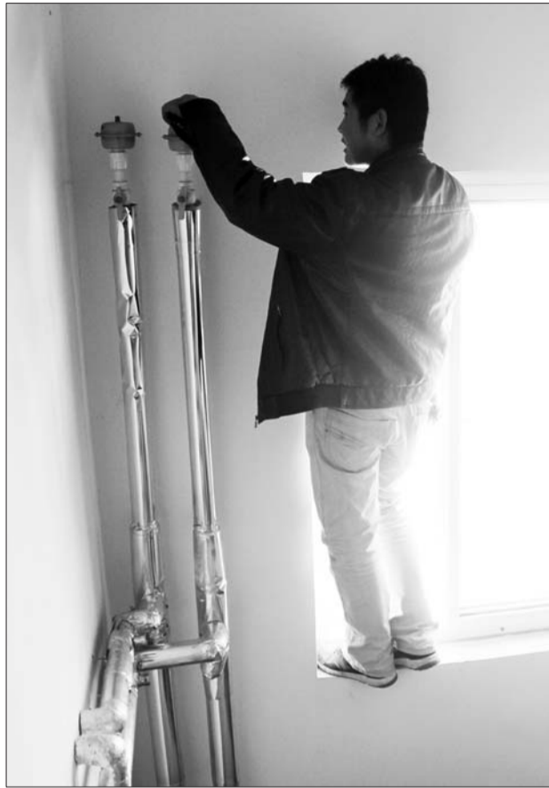
15日上午,乾城保障房小区物业的工作人员正抢修管道。本报记者 马志勇 摄
