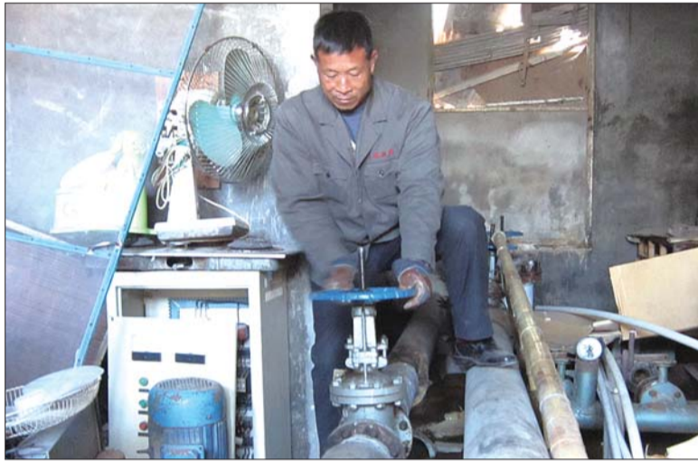
▲15日上午,兴海路换热站的工作人员为碧海水利小区开阀供暖。 本报记者 李玉涛 摄
