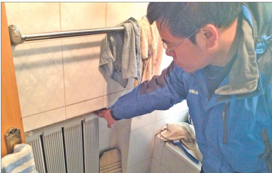
建行宿舍一户居民家里的暖气片还冰凉。 见习记者 陈熹 摄
