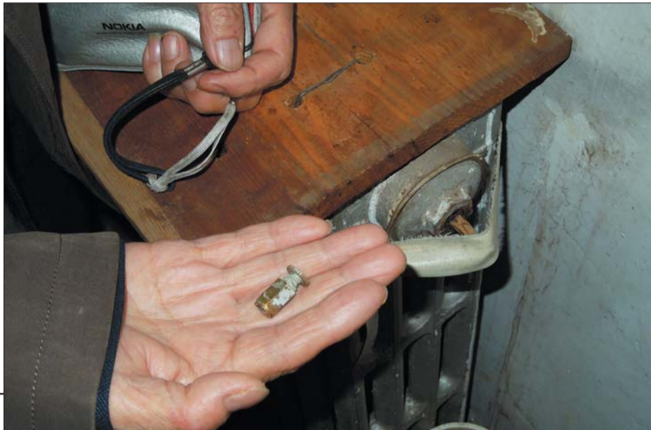
►陈康华家一组暖气片的排气阀已完全断掉,只能用一根竹棍堵住漏水的地方。见习记者 刘雅菲 摄
