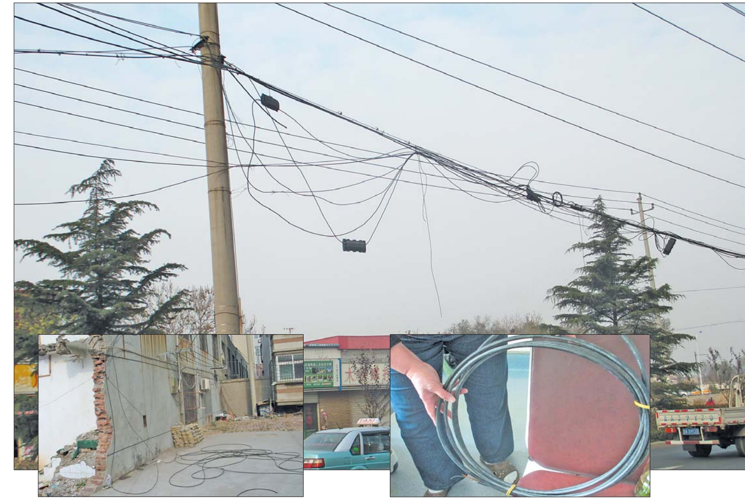
事故发生后被警方扯掉的线缆。
