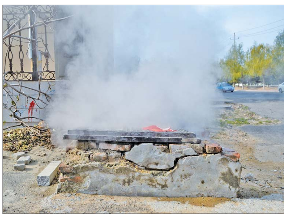
▲正在泄露热气的管道井。 见习记者 赵辉 摄
