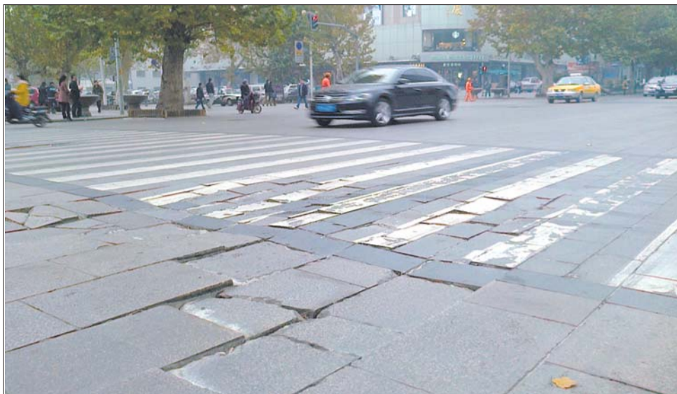
泉城路与天地坛街交叉口西侧人行道处一二十块石板破损凹陷,路面损坏严重。 本报记者 殷亚楠 摄
