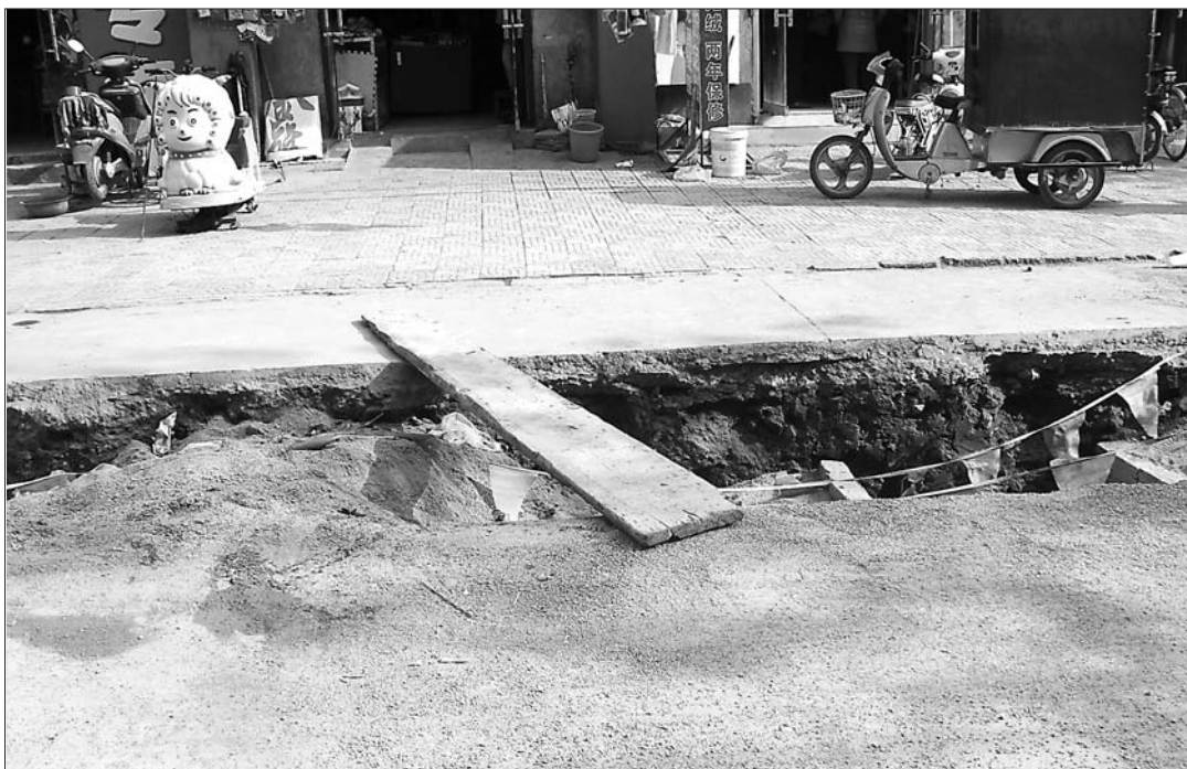
坑上面放着一块木板,供市民行走。 本报见习记者 李芳 摄
