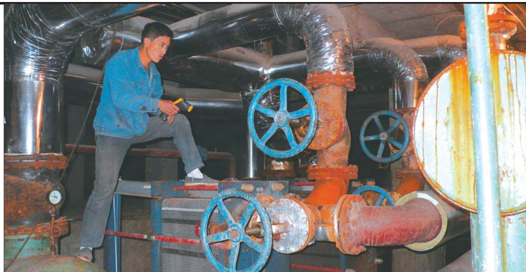
▲23日上午,菏泽市热力部门工作人员对一小区自管站进行检查。 本报记者 景佳 摄
