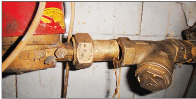
▲刚安装的供暖管道已经断裂。
