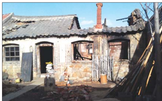
老屋被烧塌了两间。记者 苑菲菲 摄
