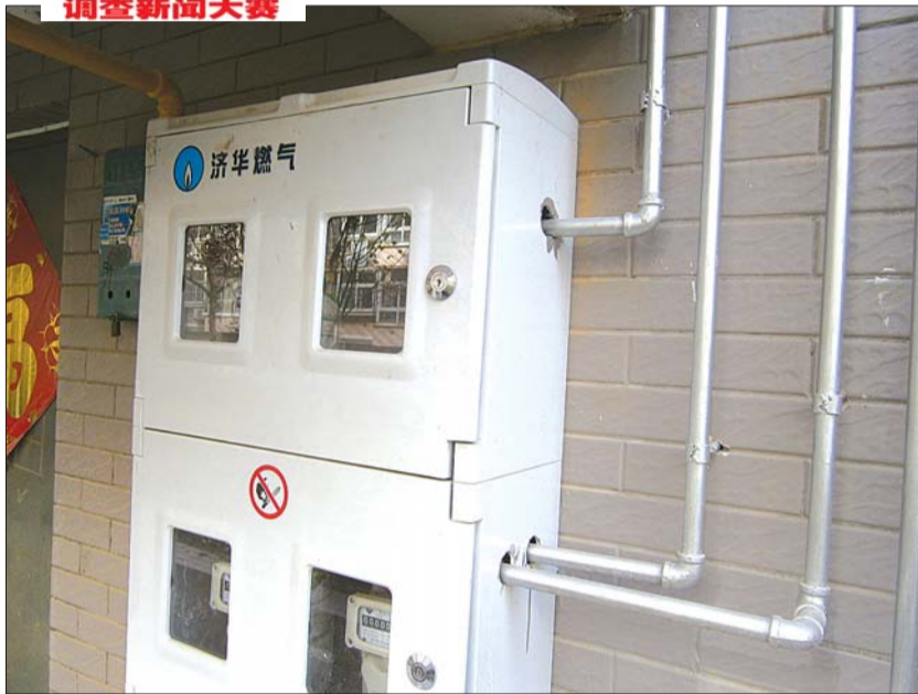
▲汇富苑小区内,已经装好的燃气仪表箱上注有“济华燃气”字样。
