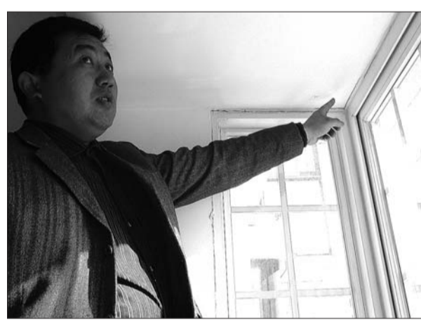
装修完不久,孙飞家的墙体就出现好几条裂缝。
