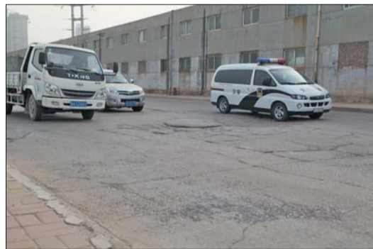
道路破裂、坑洼像“烂肠”。
