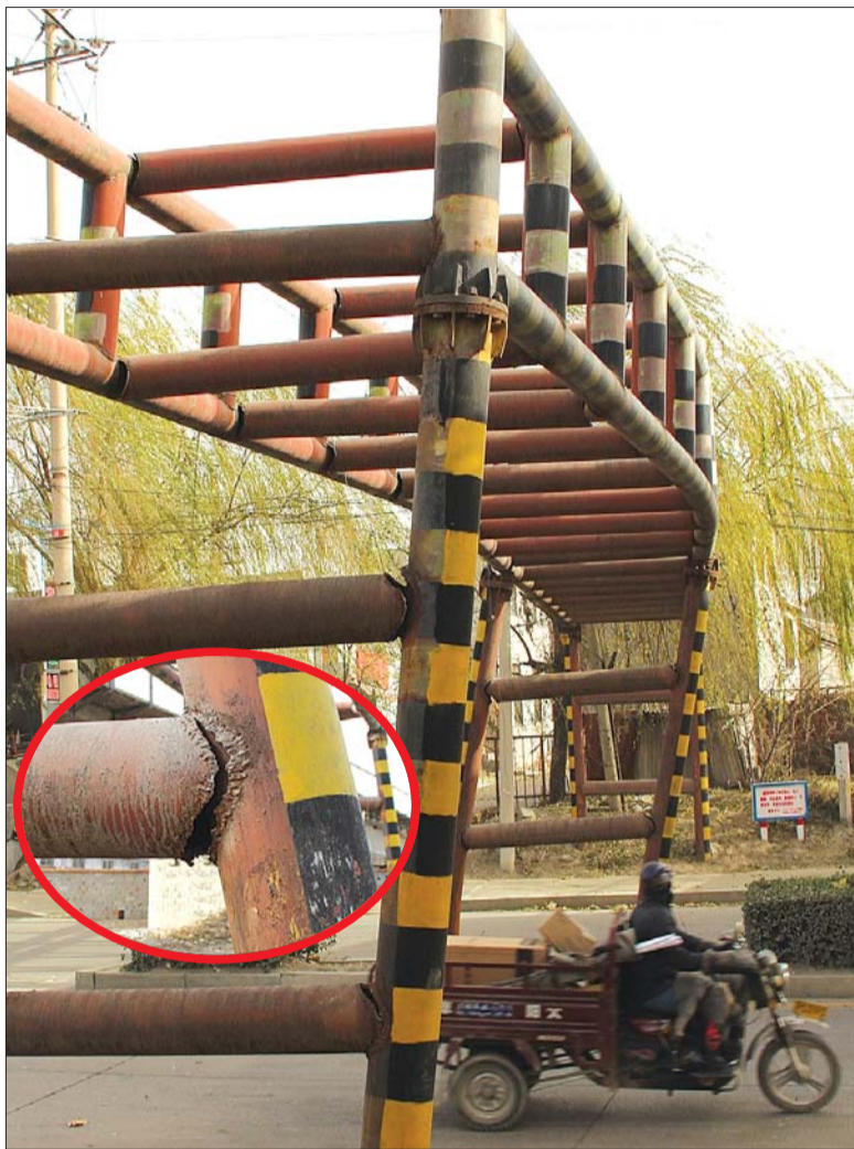
限高架钢柱断裂, 向南斜。本报记者 曹剑 摄
