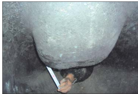
锅炉鼓起变形,最大突起尺寸一米多。通讯员 李杜伟 摄
