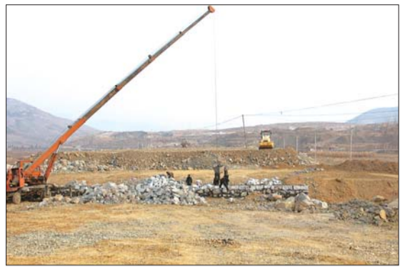
正在施工中的莒县至日兰高速龙山出入口旅游专线现场。
