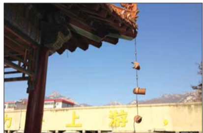
亭子顶部瓦片脱落,被电线挂在半空中。本报见习记者 邹文鹏 摄
