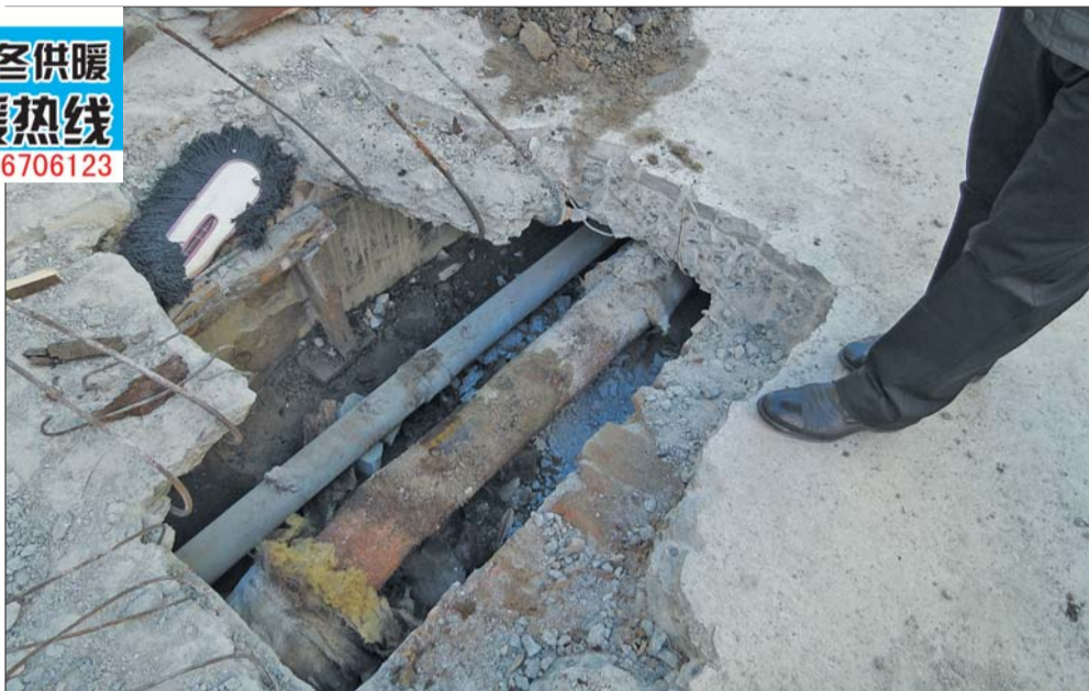
开元山庄内的二次管网已经锈迹斑斑,经常出现爆管的情况。 见习记者 刘雅菲 摄 (资料片)
