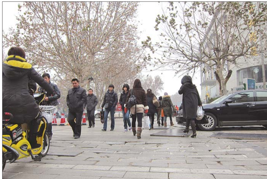
泉城路经公交车等机动车碾轧,路口石板路面破损严重。 本报记者 王光照 摄
