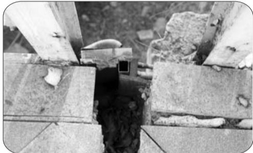
▲24日,东方红路岔河桥面上发现有裂缝。
