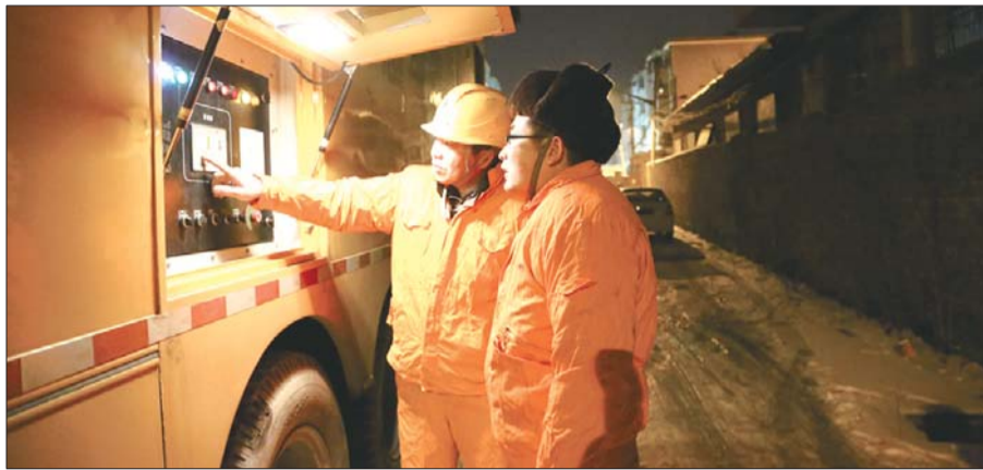
发电车在东明县三八路居民区现场发电。
