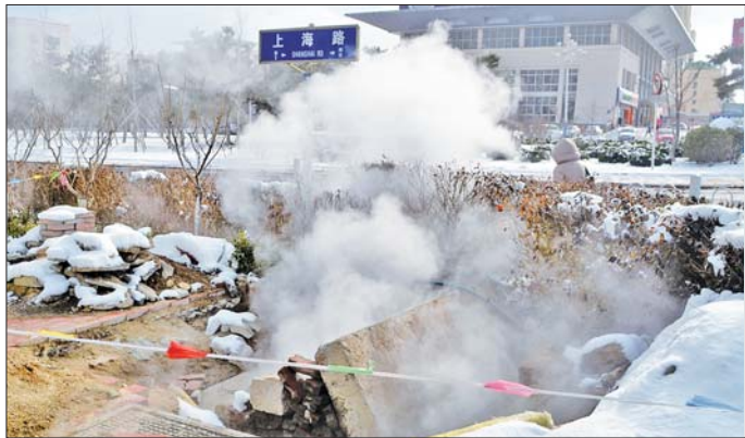
正在泄露热气的管道井。见习记者 赵辉 摄
