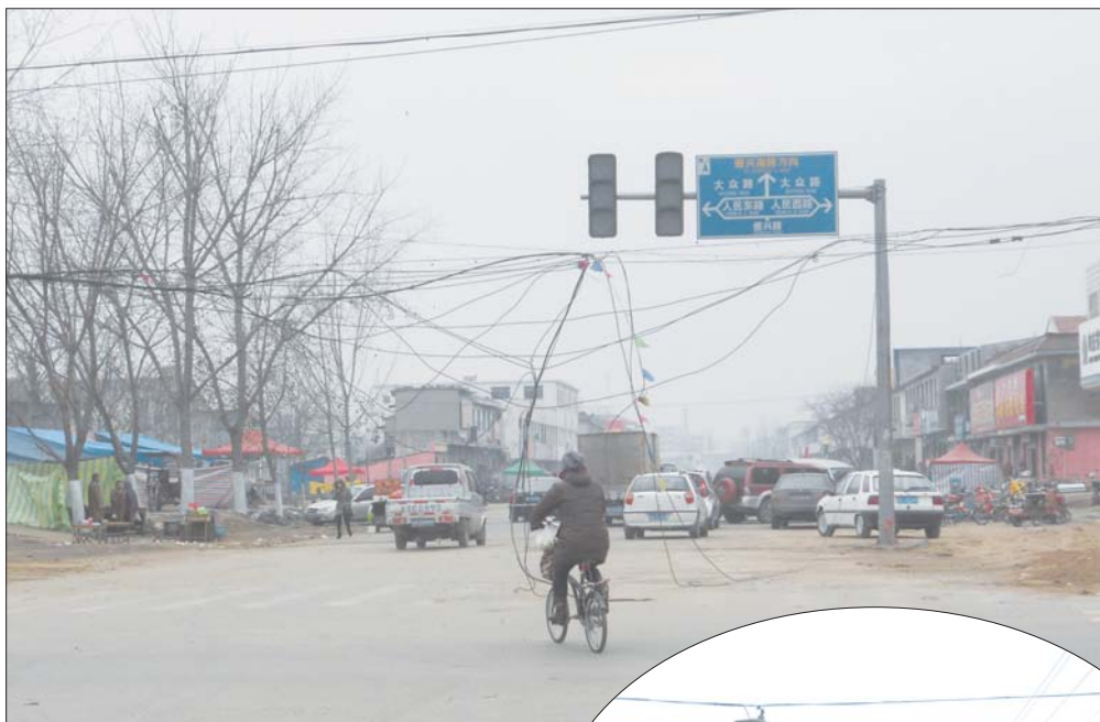
▲20日上午,振兴路与人民路交叉口悬空的光缆线给行人造成不便。
