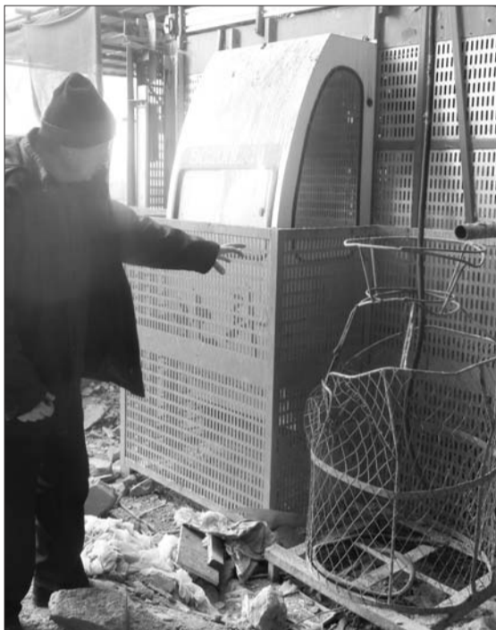
升降机两侧近150米的电缆只剩下3米的一小段。
