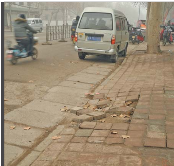
有些人行道破损可以明显看出和管道施工有关。
