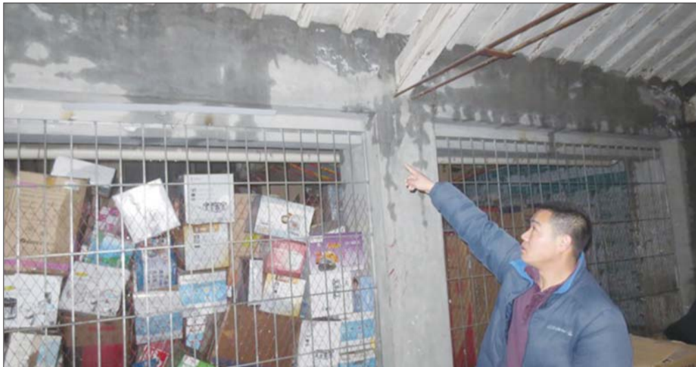
宋先生向记者说明漏雨情况。记者 姜宁 摄
