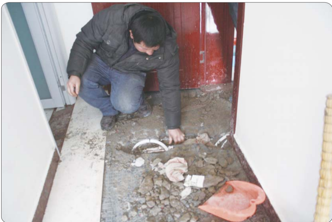
管道接口处漏水,室内瓷砖被撬起。
