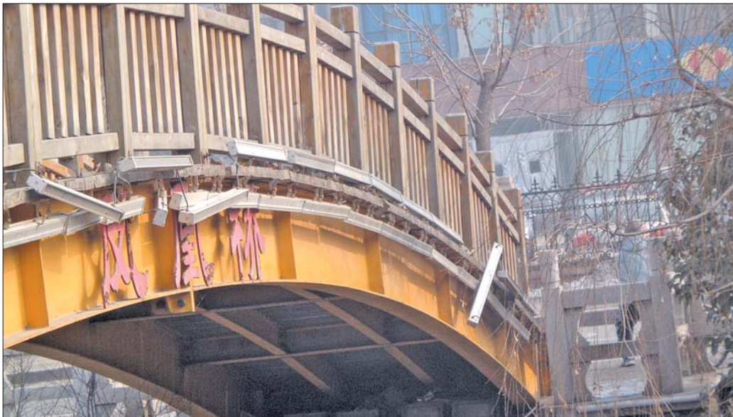
东工商河桥上被破坏的景观灯。 见习记者王兴飞 摄
