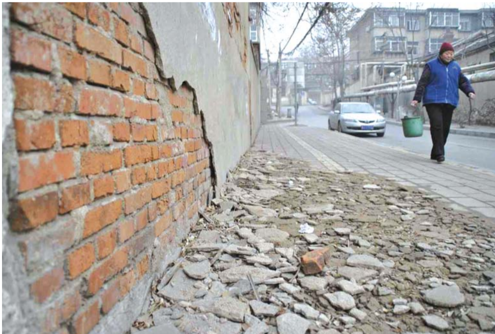
墙皮大面积脱落,给过往市民带来危险。本报记者 赵兴超 摄
