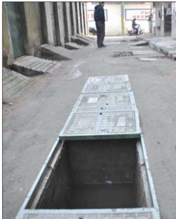
水表箱内满是污水。本报记者赵兴起 摄
