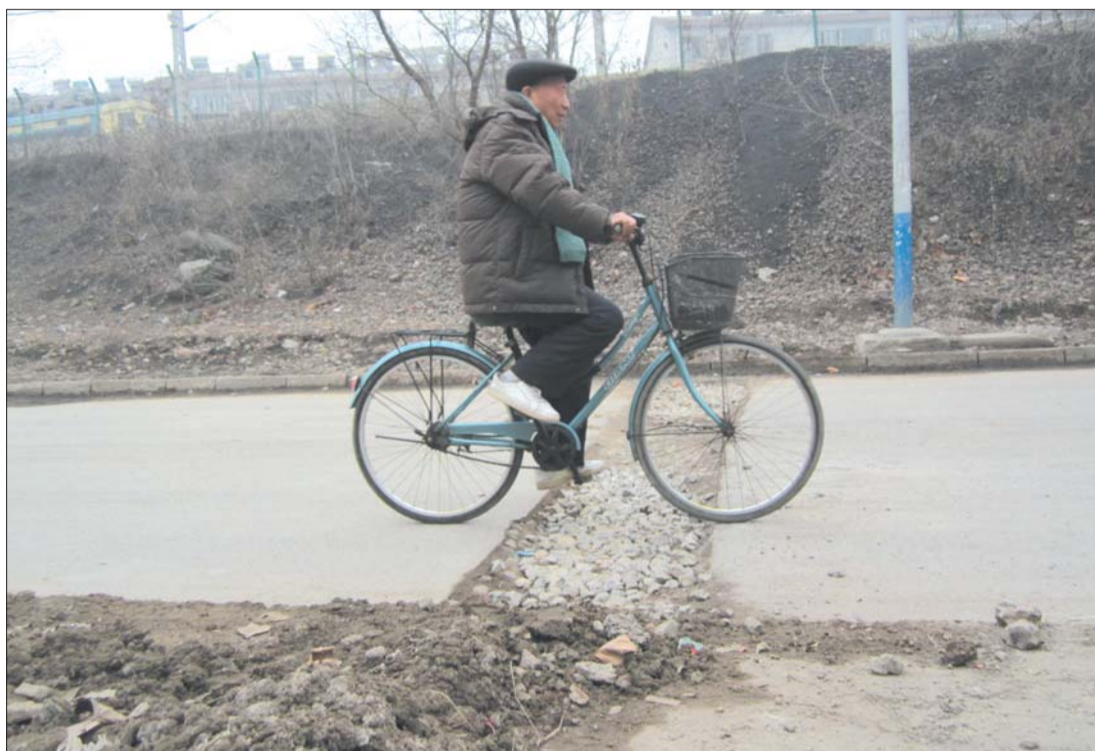
自行车经过路面上的这些坑槽时,很是颠簸。 见习记者 许建立 摄
