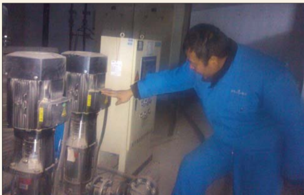
物业工作人员调试加压泵。
