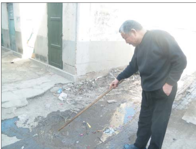
总是冒污水,可愁坏了周围居民。记者 刘杭慧 摄
