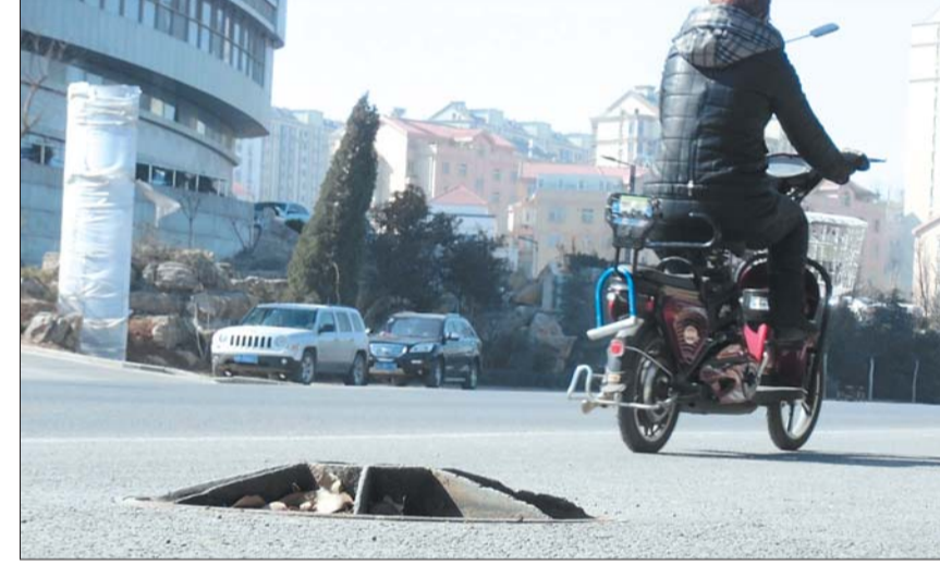
雨污水井盖反着盖,凸出地面15厘米高。 实习生 刘旭 摄
