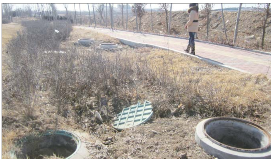
绿化带里多口井都没了井盖。记者 侯艳艳 摄
