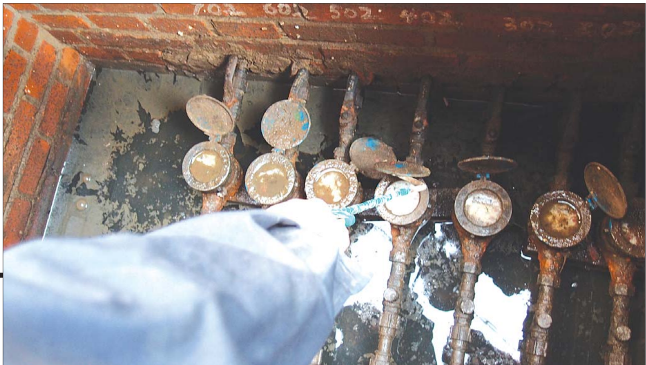
在凤林小区北区5号楼前,水表井中有污水渗入,污水颜色发黑,还漂着油花。 本报记者 赵丽 摄
