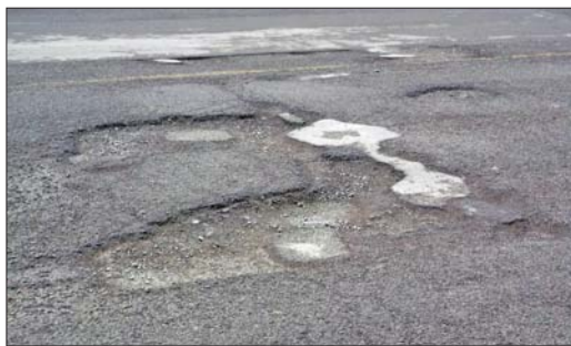
路中间的坑。见习记者 朱洪蕾 摄
