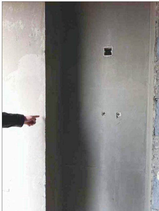
侯先生指着半封闭阳台的外墙说,这里应该做保温,但没做。 记者 李园园 摄
