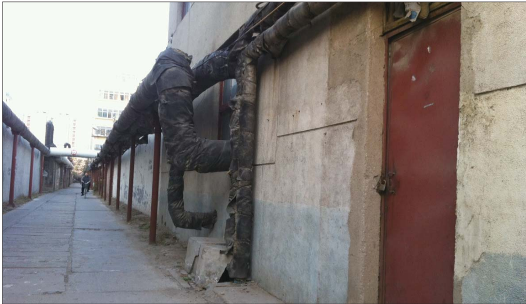
当供热公司直供站开始试暖的时候,城区大部分自管站还没有动静。(资料片) 本报记者 张召旭 摄
