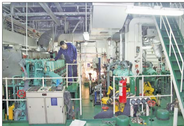
▲孙凯在客船的主机室检查主发动机运行情况。
