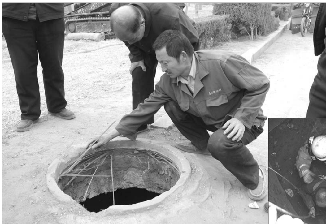
井盖底座断裂处露出大量竹条。本报记者 赵苏炜 摄
