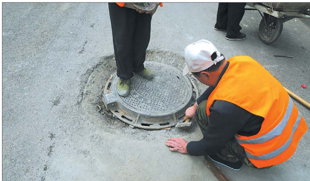
17日,黑虎泉附近的青龙街,市政工人在修整路面的井盖子。此前道路修整,导致部分井盖子与路面存在高度差,成为行人和车辆的绊脚石。 本报记者 周青先 摄影报道
