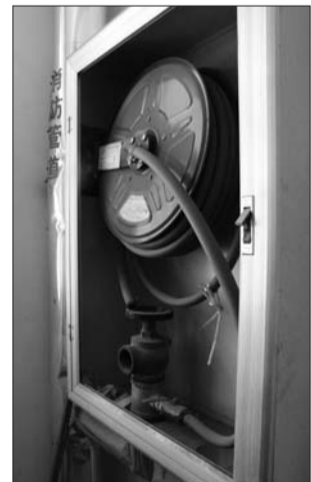
受损的消防设施。 本报记者 张超 摄
