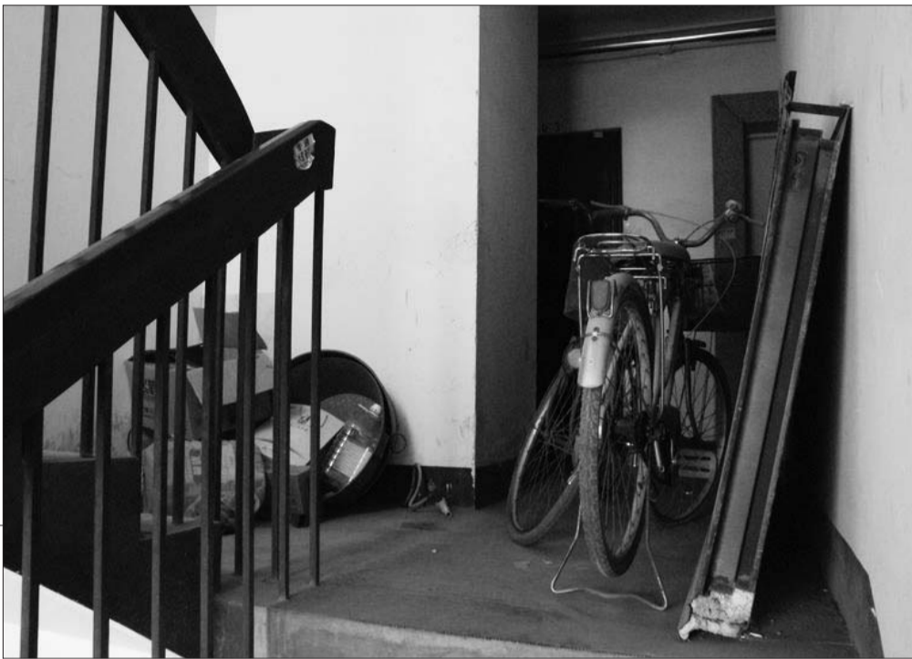
被杂物挤占的消防通道。 本报记者 张超 摄
