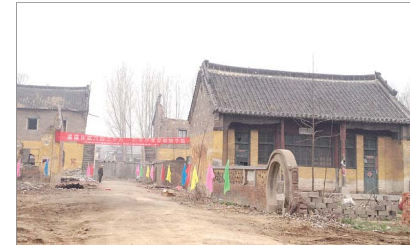
“孙家故宅”出现不同程度的破损。(资料片)
